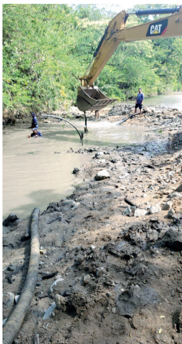
Al sitio del daño se trasladaron los operarios.
