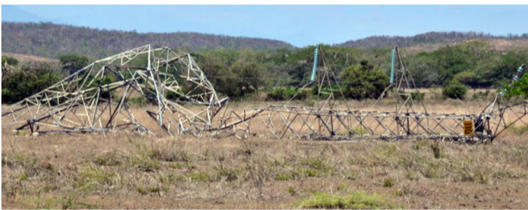
Las torres 051 y 052, que atraviesan la comunidad de Yaguarito, en el Resguardo de El Pozo – Rodeito, se cayeron.
