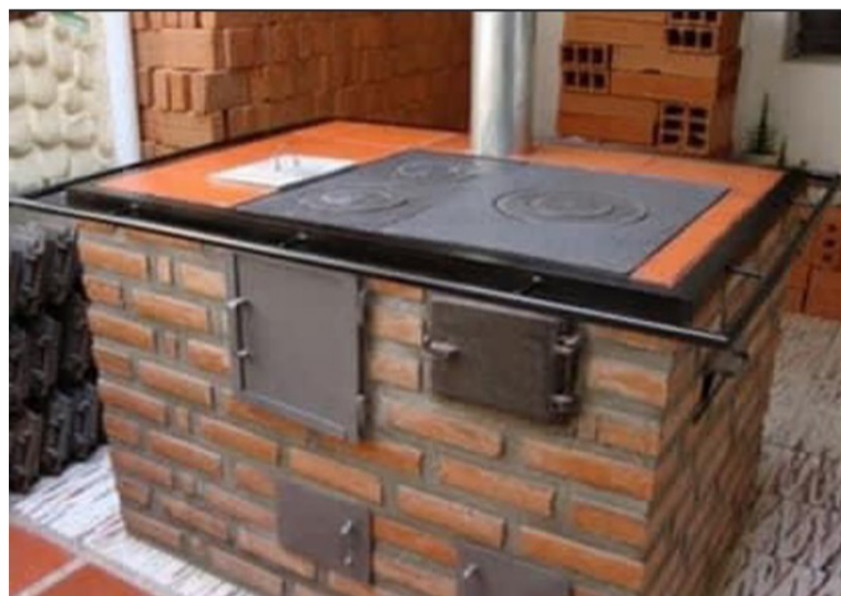
La construcción de las estufas inicia para el mes de mayo del presente año y beneficiará a 500 habitantes.
