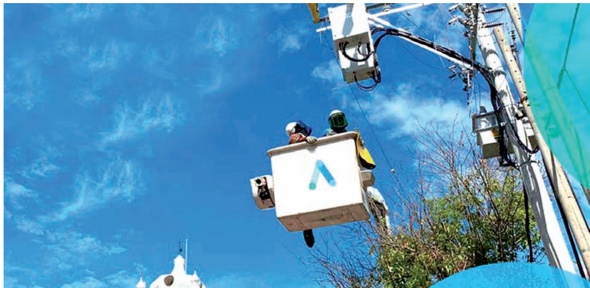
Cuadrillas de Air-e descubren robo de energía y conexión ilegal de transformadores.
