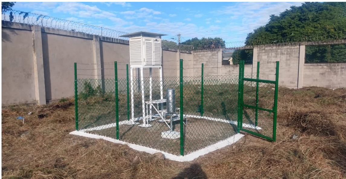
Las estaciones fueron instaladas en 8 municipios, fundamentales para los monitoreos.
