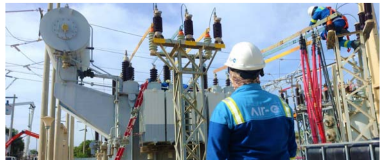
La empresa Air-e pondrá en funcionamiento un segundo transformador de potencia en el municipio de Fonseca.
