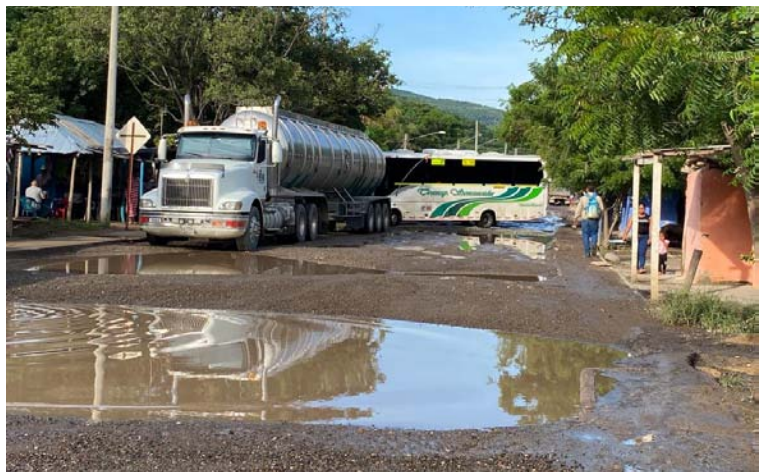
El tramo vial se encuentra totalmente destrozado, y además, las lluvias han afectado aún más la vía.
