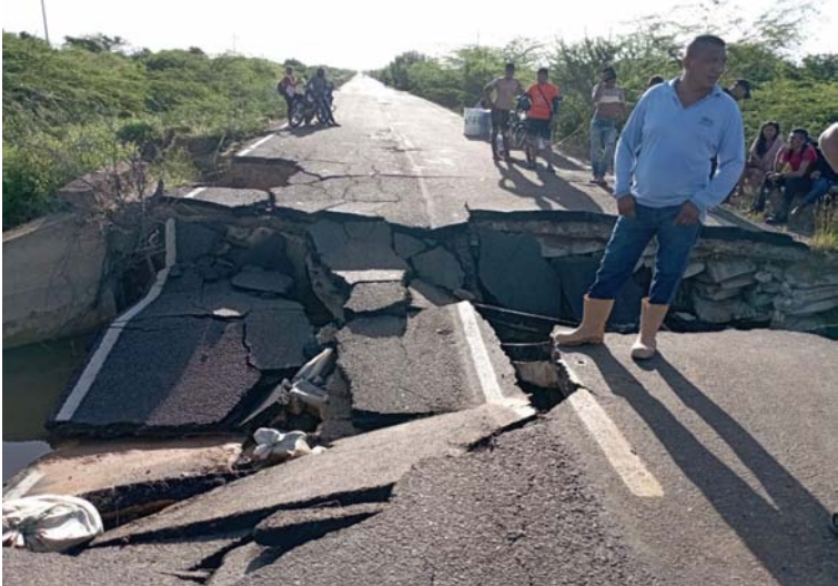
La vía entre Uribia y Manaure está incomunicada luego de que cediera el pavimento por las fuertes lluvias.
