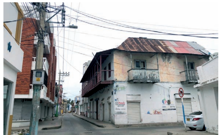
Viviendas del Centro Histórico de Riohacha que requieren inversión de sus propietarios para restaurarlas.
