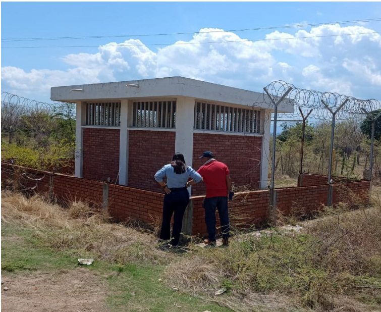
Fueron hurtados elementos del cerramiento perimetral, lo cual puede ocasionar riesgo para la comunidad.
