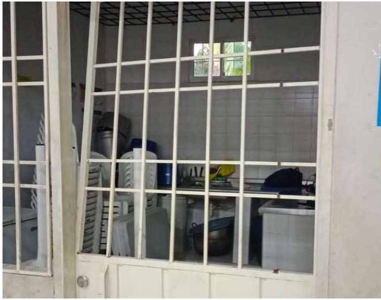
La comunidad educativa dijo que los delincuentes ingresaron a la edificación violentando los protectores metálicos.
