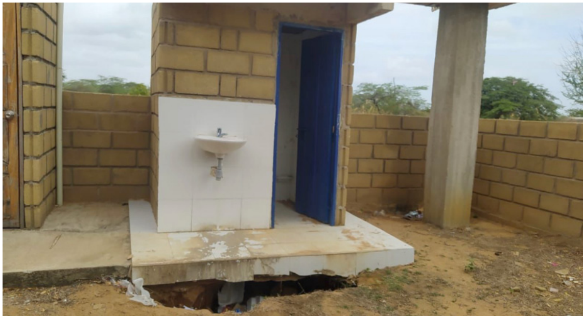
La situación que indignó a la comunidad dejó graves daños en la infraestructura.
