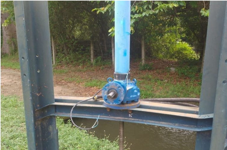
El motor funcionaba para controlar la apertura automática de la compuerta que regula el ingreso de agua a la planta.
