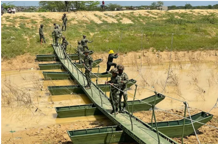
Usuarios denunciaron que el puente se habría construido sin las licencias y los estudios pertinentes.
