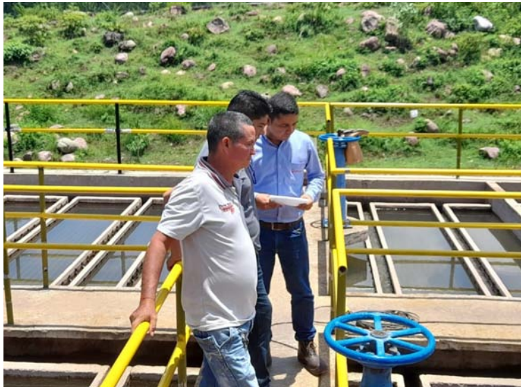
Se verificó que la planta no está en capacidad de suministrar las 24 horas la cantidad necesaria de agua potable.
