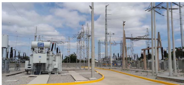
Air-e realizará mantenimiento en uno de los transformadores de potencia de la subestación Riohacha.
